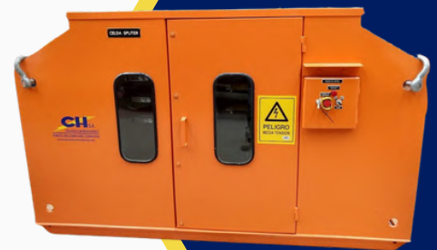
Celda SPLITTER CON Seccionadores seccionadores al aire NAL, clase 24 kV, 630 A, 31,5 kA y enchufes media tensión 25 kV, 700 A, fijo (entrada) Patton&Cooke, Relé de monitoreo de circuito de tierra y Transformador de servicios auxiliares 1 kVA, 13.800/400-231 V.
